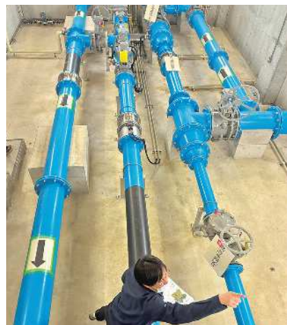
令和7年から稼働を始めた直結配水型高根配水場
