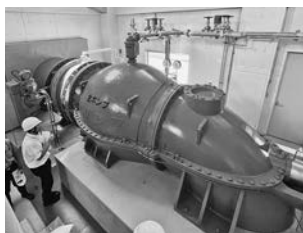
巨大・強力な排水ポンプ 人のサイズと比較して！
