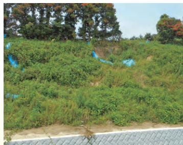
2次災害が懸念される斜面（民地と町有地）
