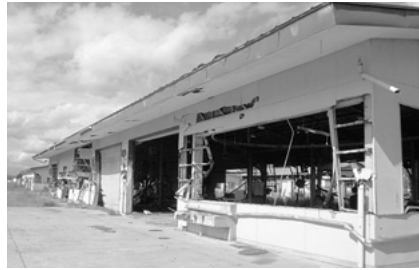
被災建物 現在も随所に残されている
