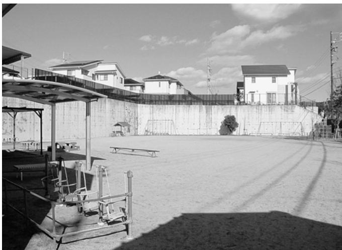
宮津保育園園庭の擁壁
