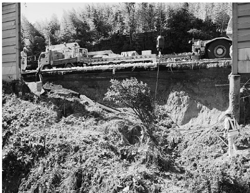
阿久比 I.C. 崩壊現場
