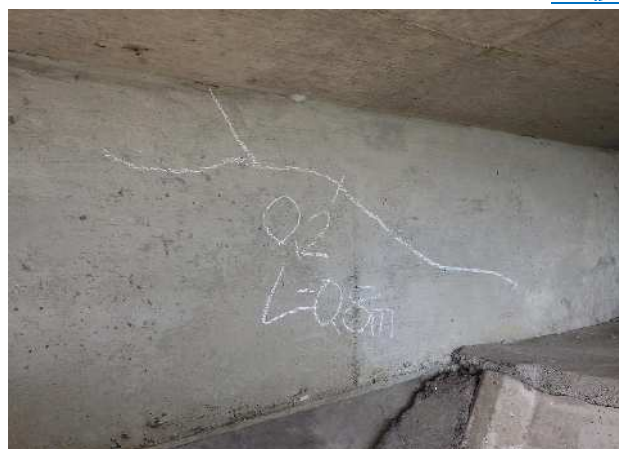
橋梁__主桁 : ひびわれ
