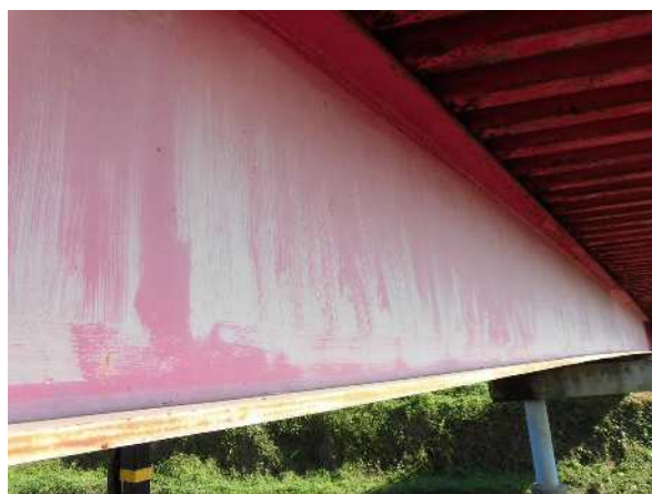
橋梁(鋼部材) : 防食機能の劣化
