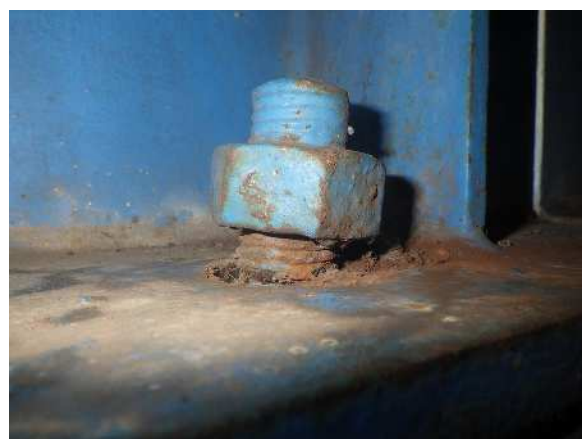
橋梁__支承部 : 変色・劣化
