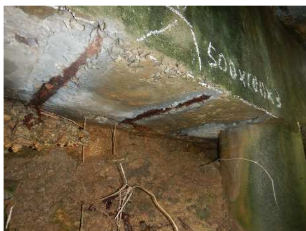
橋梁__堅壁 : 剥離・鉄筋露出
