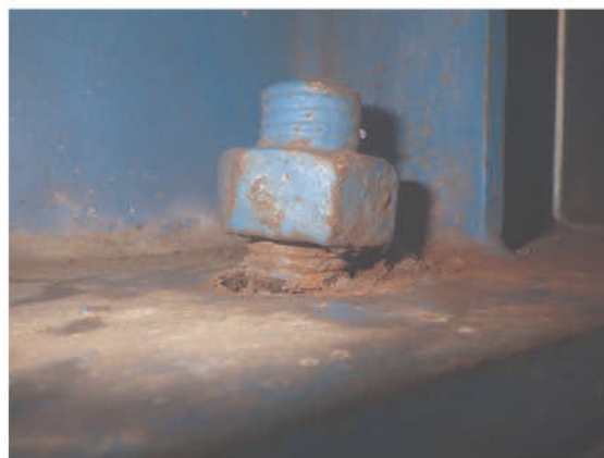
橋梁__支承部 : 変色・劣化
