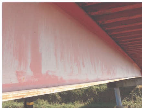
橋梁(鋼部材) : 防食機能の劣化
