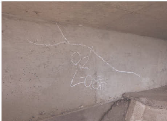
橋梁__主桁 : ひびわれ
