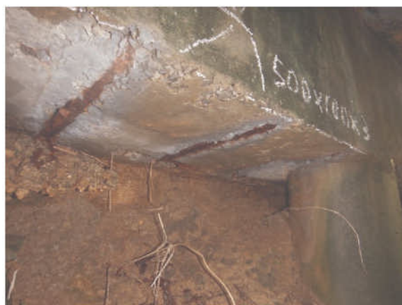
橋梁__堅壁 : 剥離・鉄筋露出
