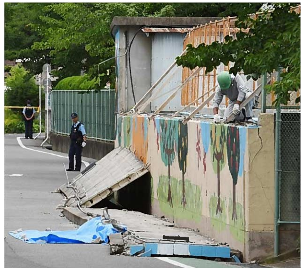
大阪北部地震によるブロック塀の倒壊（大阪府 HP より）
