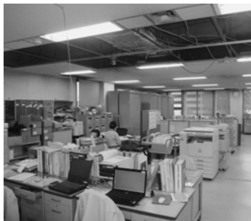
区役所の天井も壊れたまま
