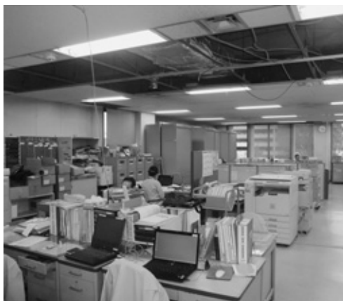
区役所の天井も壊れたまま
