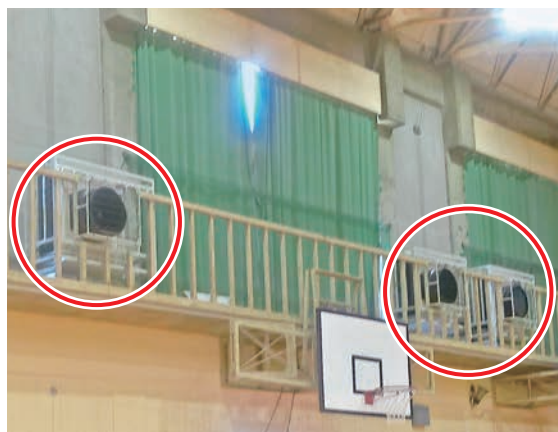
利用者から絶賛!! 空調機器の設置により快適な環境となった体育館
