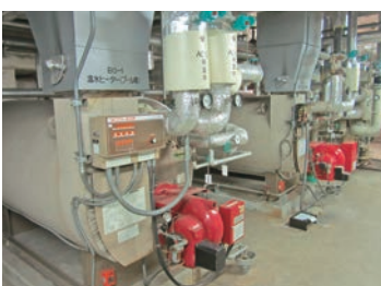
今回取替えを行うプールボイラー
