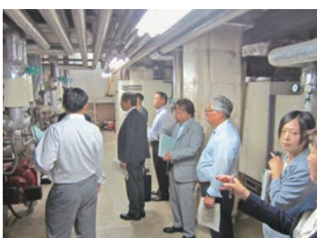
ボイラー室を見学
