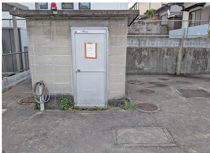
単独処理の集中浄化槽（福住園高台）
