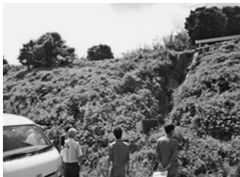
板山石亀川西側法面崩落現場
