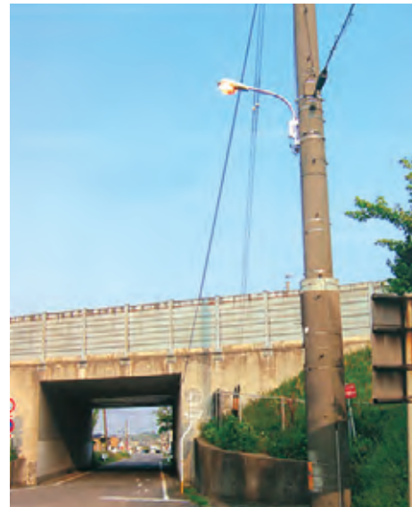
設置された防犯灯（阿久比インター東）
