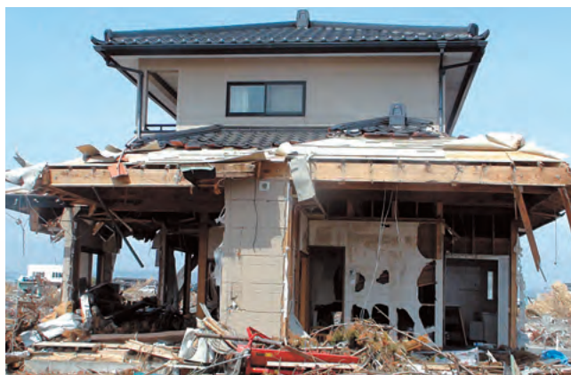
津波で被害を受けた住宅
