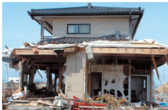
津波で被害を受けた住宅
