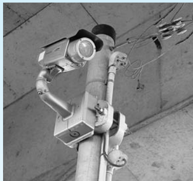
防犯カメラ（設置例）
