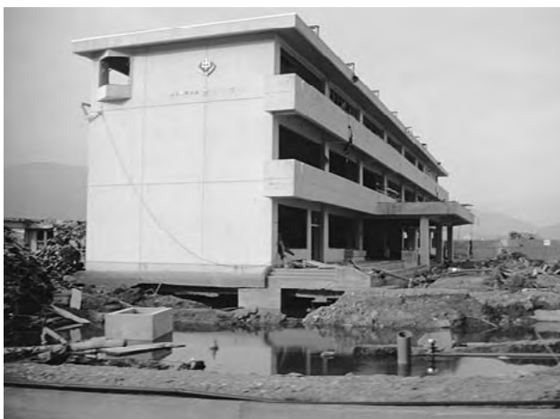
被災した中学校(岩手県陸前高田市)
