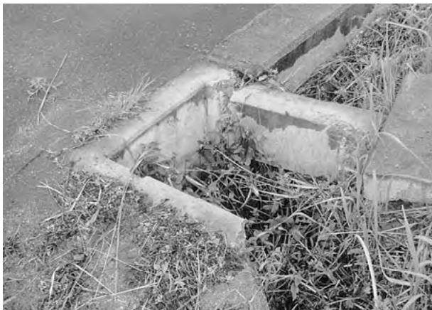
農道のグレーチング蓋の盗難
