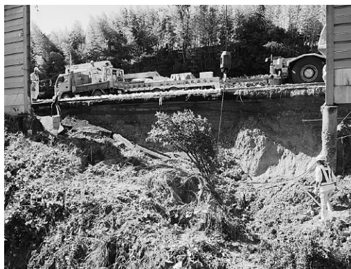
阿久比 I.C. 崩壊現場
