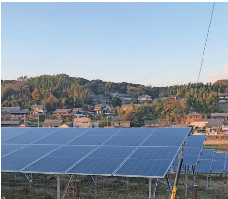
南部地区の太陽光発電設備施設
