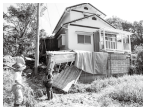
▲家全体で見ると被害は部分的
