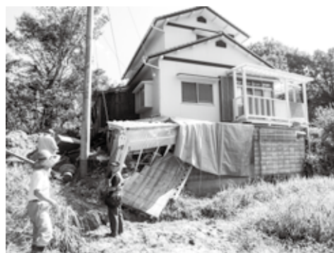
▲家全体で見ると被害は部分的
