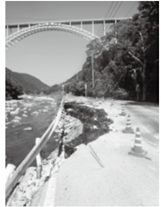
土石流でえぐれた 県道:東広島市
