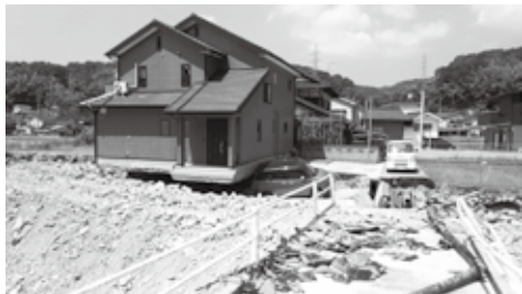
▲ 河川の増水により地盤が崩落した住宅:東広島市
