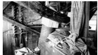
柱などが崩れた室内
