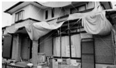
屋根の被害も多数発生
