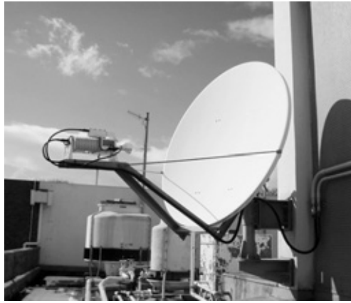
役場庁舎屋上のパラボラアンテナで受信します
