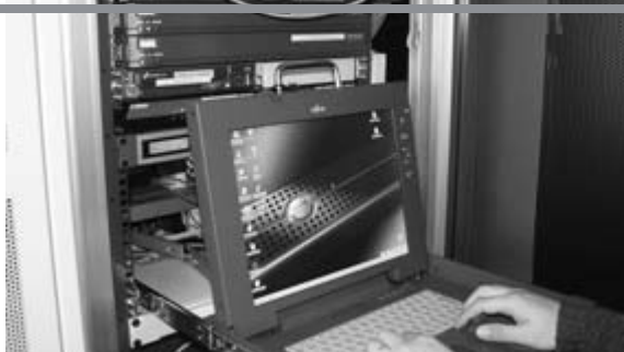
役場庁舎内の電算室
