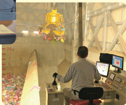
ごみクレーン操作室
