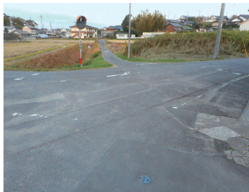
幹線道路への抜け道として交通量が増している町道2115・2114号線の変則5差路。通学路だが、停止・区画線のはく離状態は著しく、意味をなしていない。
