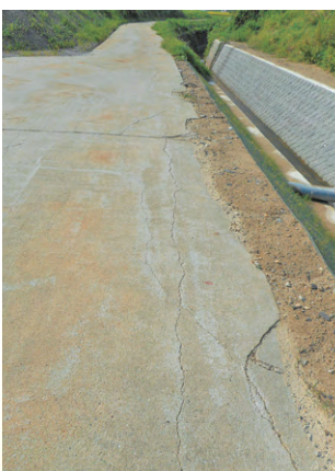
割れたコンクリート舗装の路面
