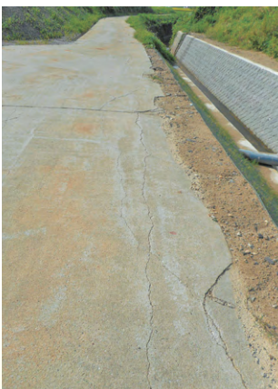
割れたコンクリート舗装の路面
