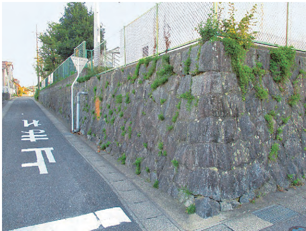
補修工事を行う必要がある石垣（南部小学校）
