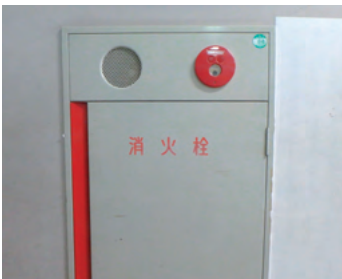
万が一の災害に備え、設置されている消火栓と制御器
