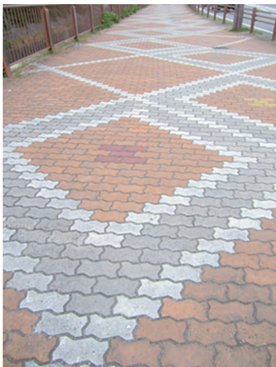
インターロッキングを用いて雨が降っても滑らない歩道
