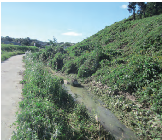
▲高さ10m、長さ90mにわたって崩れ落ちた土砂で埋まった石亀川。
