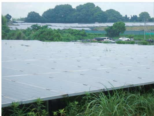
太陽光発電施設
