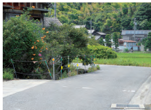
暗渠化が切望される水路 (町道2115号線の危険箇所)
