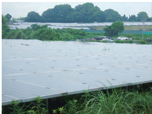
太陽光発電施設
