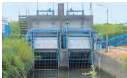
矢勝川除塵機
