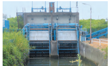
矢勝川除塵機
