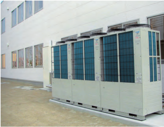
東部小学校増築校舎の空調設備の室外機 (ガス空調)
